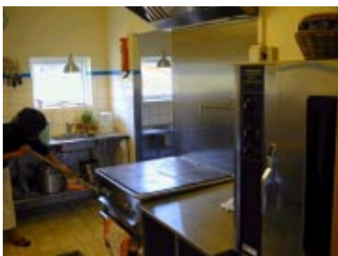
Elforbruget i fælleshusenes køkkener er stort på grund af de industrielle forhold.
